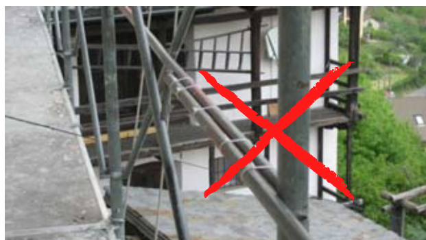
Bild 3 Kabelbinder sind nicht erlaubt. Sie sind nicht genügend fest und deshalb verboten.
