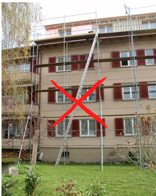
Bild 1 Leitern dürfen als Aussenaufstieg nur bis zu einer Absturzhöhe von 5,0 m verwendet werden.
