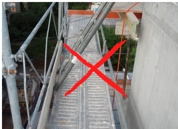
Bild 4 So nicht! Diese Leiter wird an einer instabilen Unterlage angelegt. Versagt das Bordbrett, ist der Absturz programmiert.
